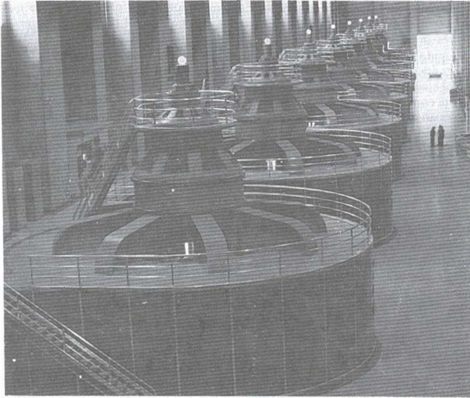
La potencia hidroeléctrica se genera utilizando la energía mecánica del agua y la inducción electromagnética. (© Tomas D. Friedmann 1971/Photo Researchers, Inc.)
